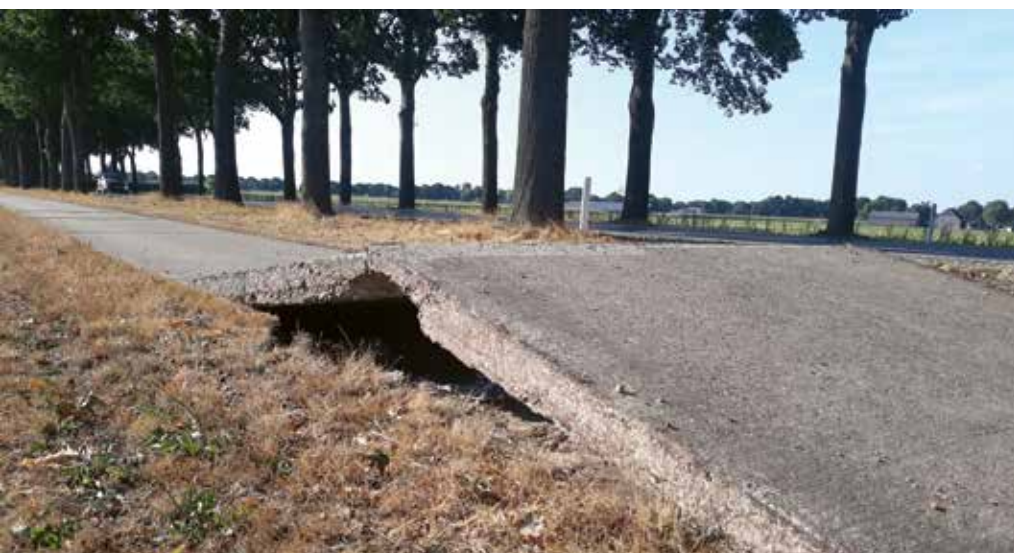
Thermische uitzetting betonnen fietspad
