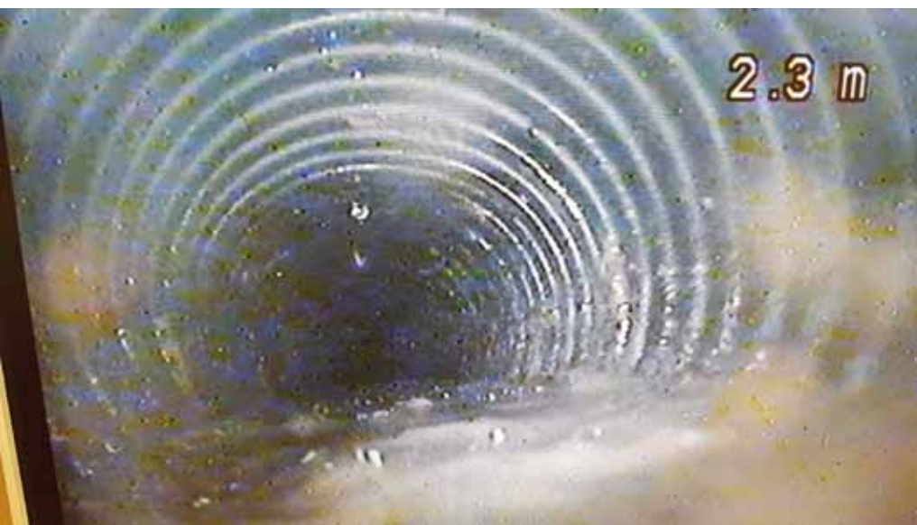
Dit ziet Ton de Kroon op zijn beeldscherm als de camera de drainage in gaat.
