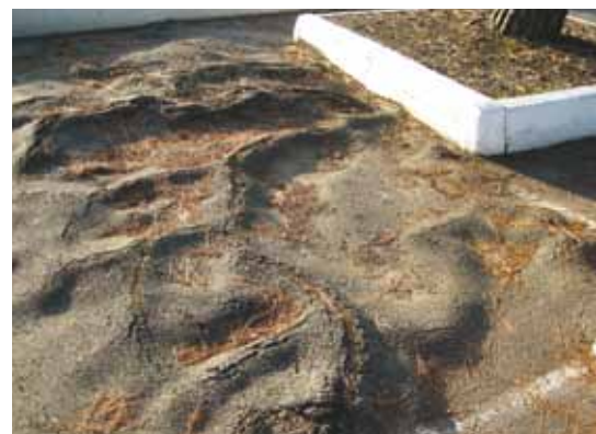
Wortels bevinden zich vaak in de funderingslaag onder de verharding.
