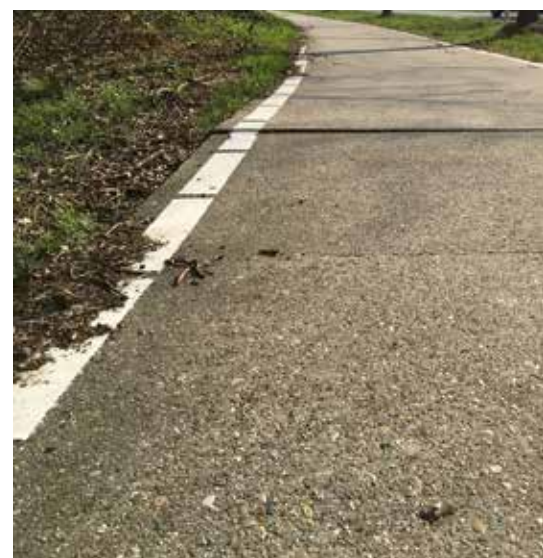
Beschadiging door wortelopdruk
