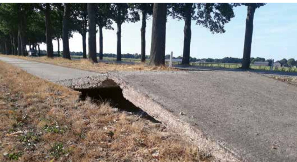
Thermische uitzetting betonnen fietspad
